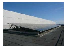
川越事業所の太陽光発電施設
