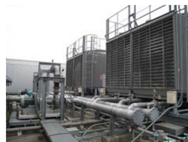
本社の冷却水設備
